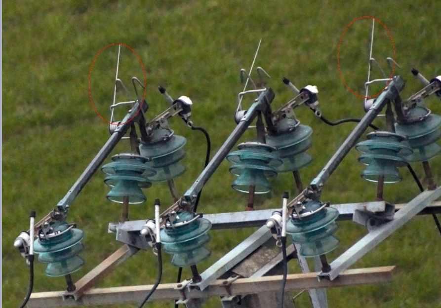
Au sommet de ce poteau, deux des trois fouets constituant ces interrupteurs aériens sont sortis de leur logement. L'algorithme doit les distinguer de celui du milieu, resté en place.
